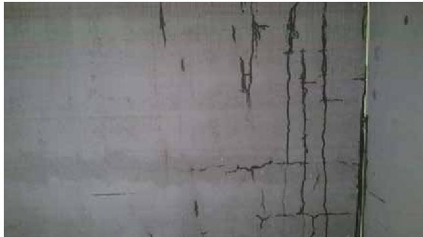
Wasserführende Risse im WU-Beton [Quelle: Leitfaden für WU-Beton, 1. Auflage 2019; Holcim (Deutschland) GmbH]
